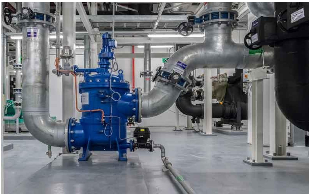
تعمیر و نگهداری موتورخانه
