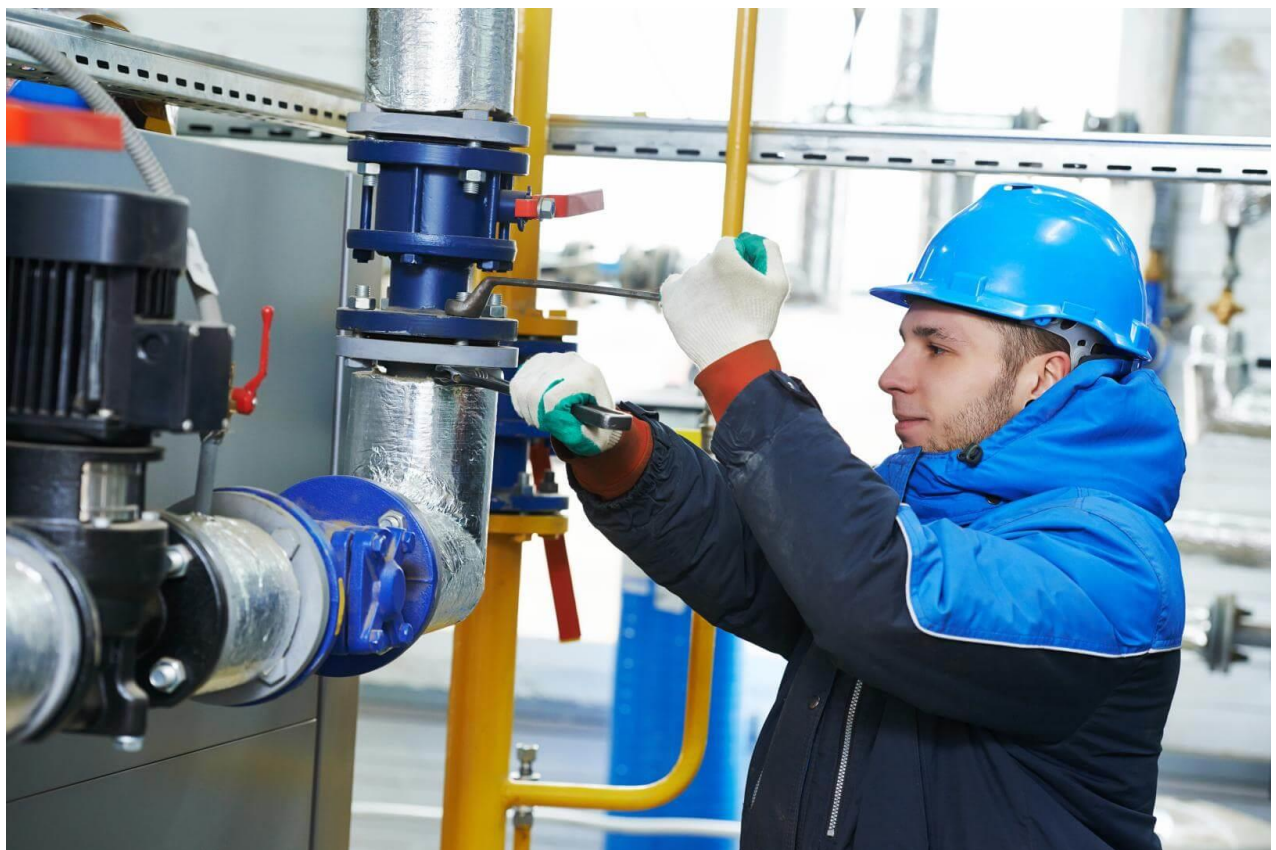
تعمیر و نگهداری موتورخانه
